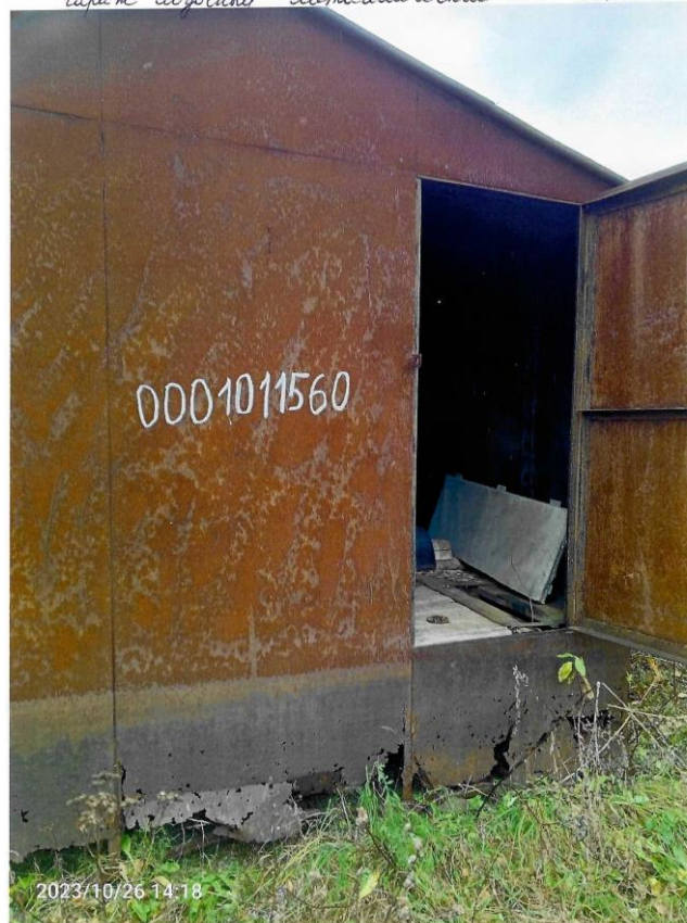
гараж подотный металлический инв № 0001011560
